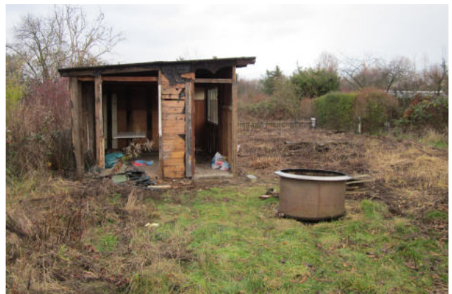
Zerstörte Laube auf verlassener Parzelle
